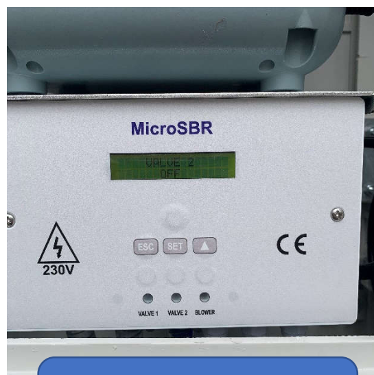
Vārsts 2 Notekūdeņu izsūkņēšana - sūknis ZILA
